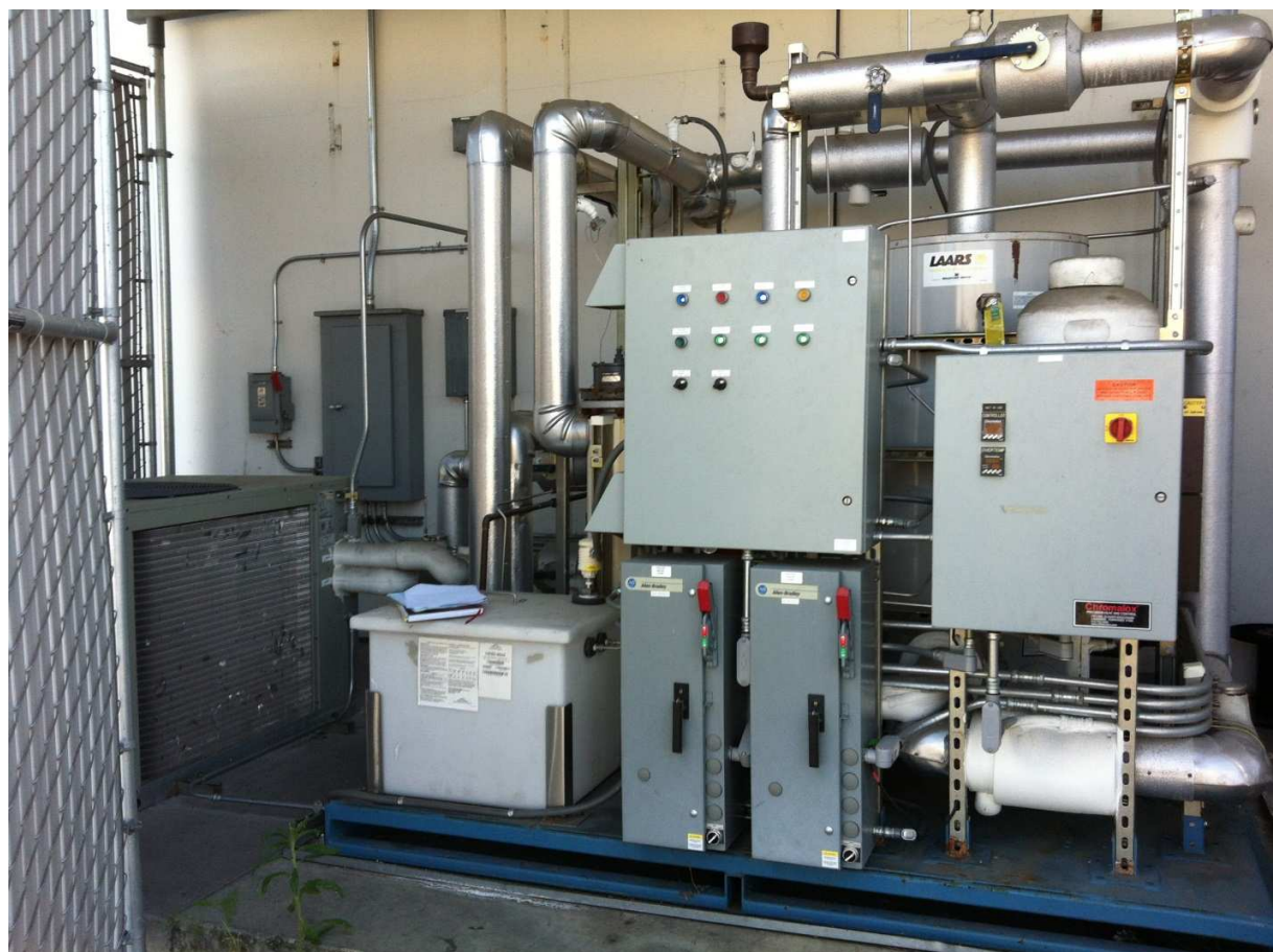
图 2 系统 1 的外置制冷/热的机组
