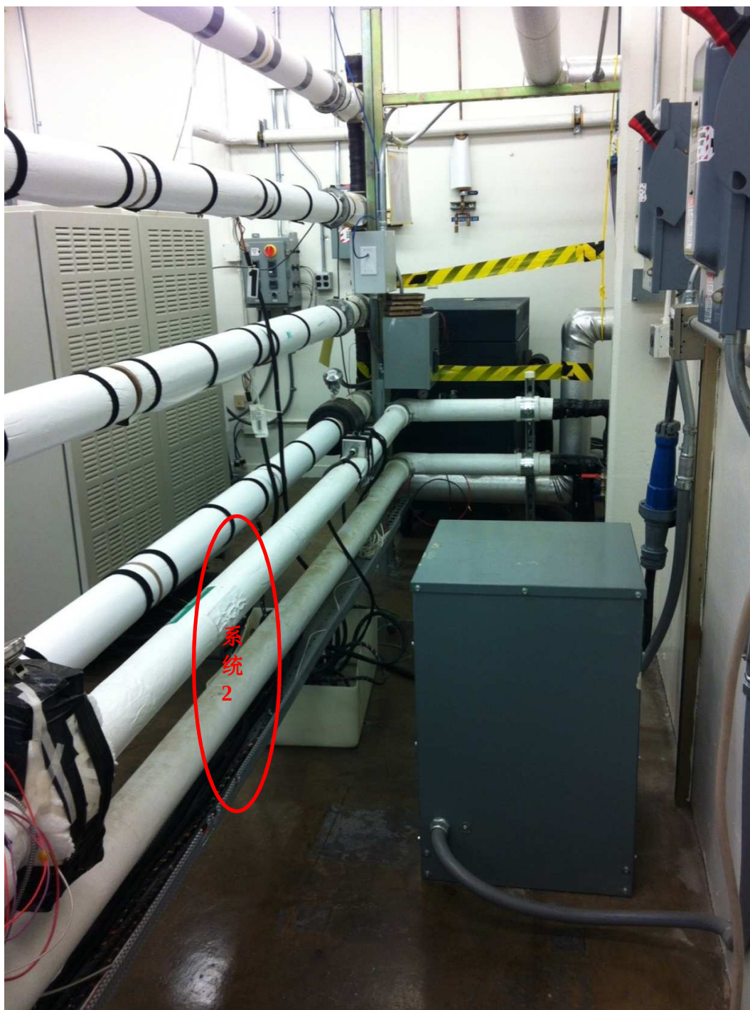
图 3 系统 2（内侧靠墙的两根竖直放置的管道）
