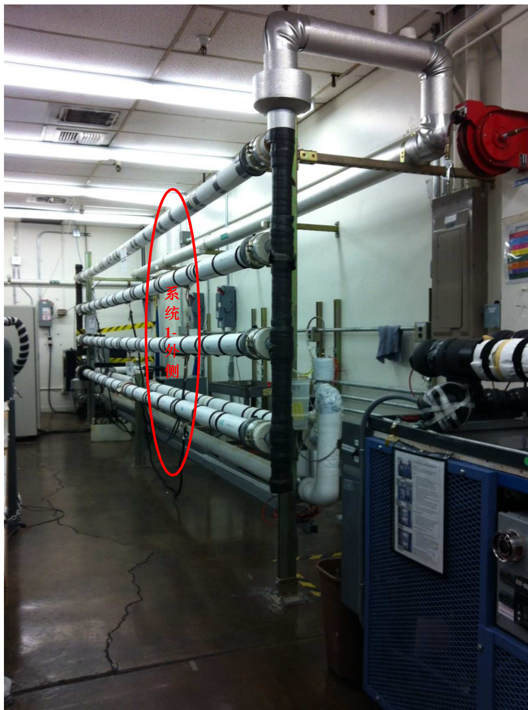
图1 系统1（外侧的四根垂直放置的管道）
